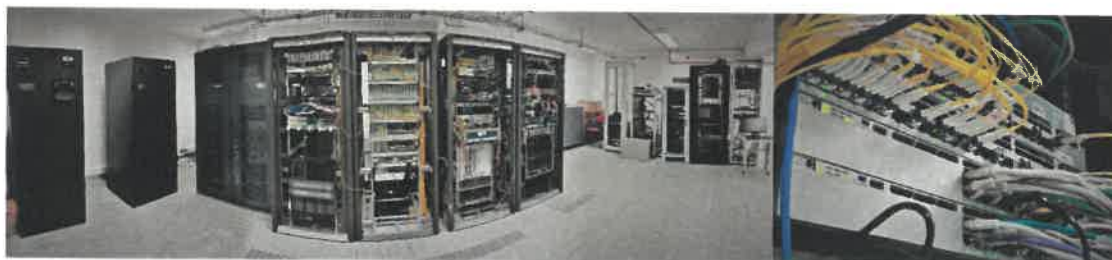
DataCenter Partilhado AMTQT / CIM-TTM
